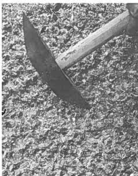
Ciment ravalé au pic, lycée Camille-Sée, 1934.
